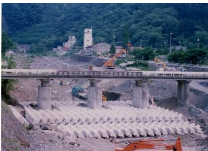
山梨県南巨摩郡早川町 春木川 コーケンブロック 2.0 × 4 (8t級) コーケンブロック 2.0 × 5 (10t級)
